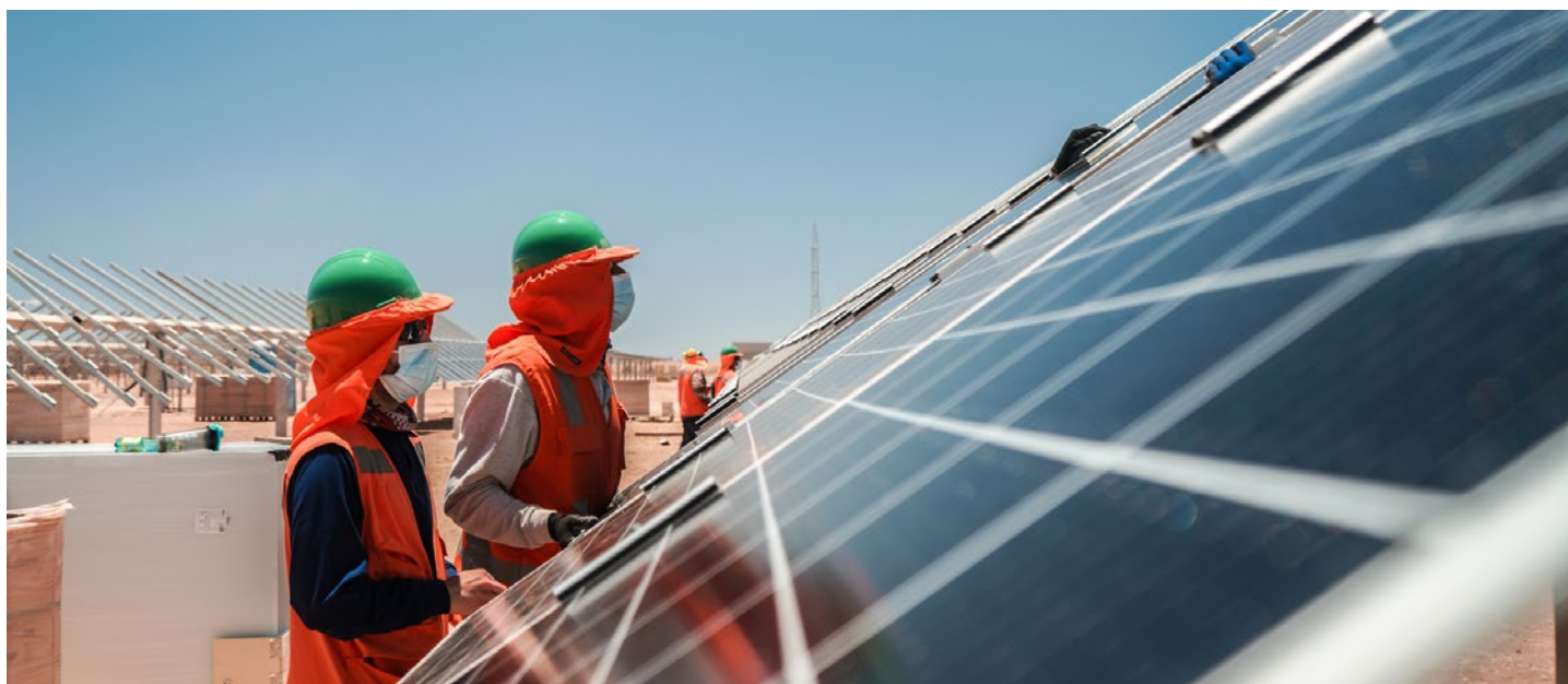
PV Freiflächen-Projekt, La Huella in Chile
