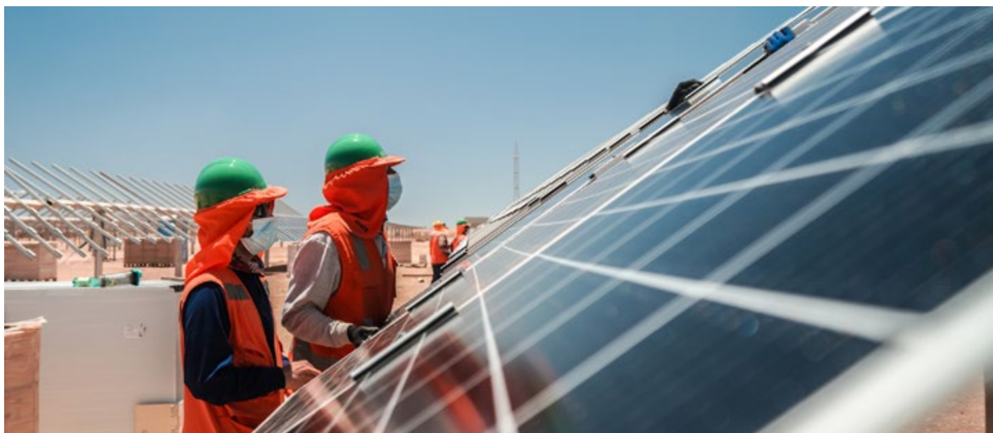
PV Freiflächen-Projekt, La Huella in Chile
